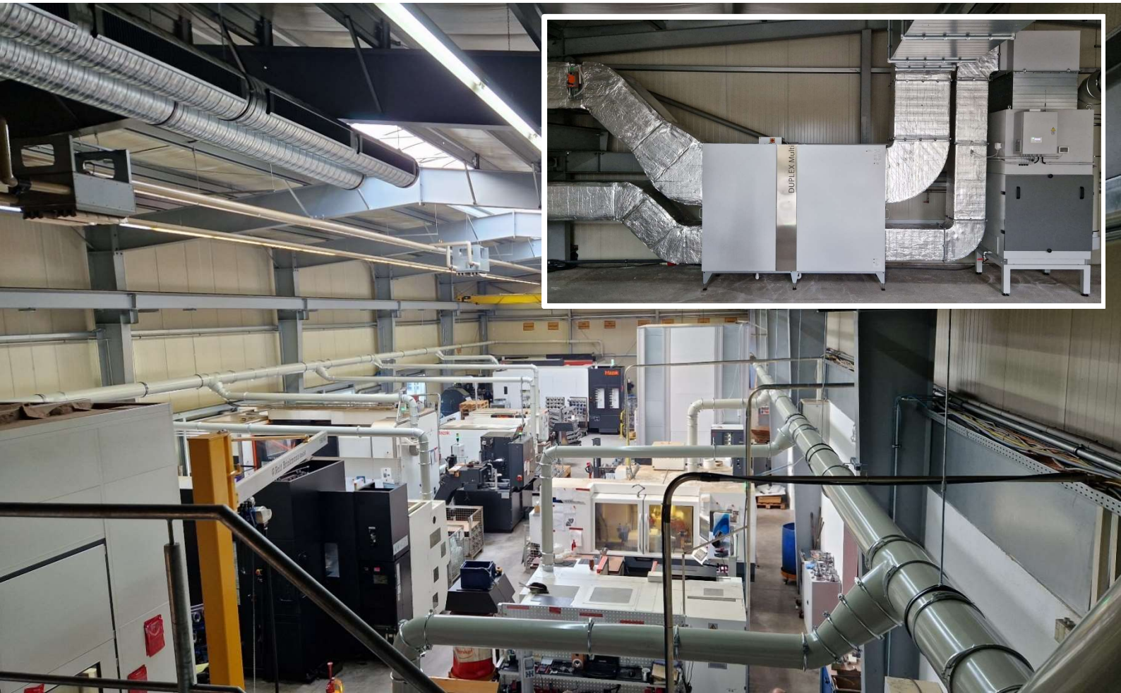
Bild: Zentrale Absauganlage mit Zuluftanlage (oben) für 10 Maschinen
