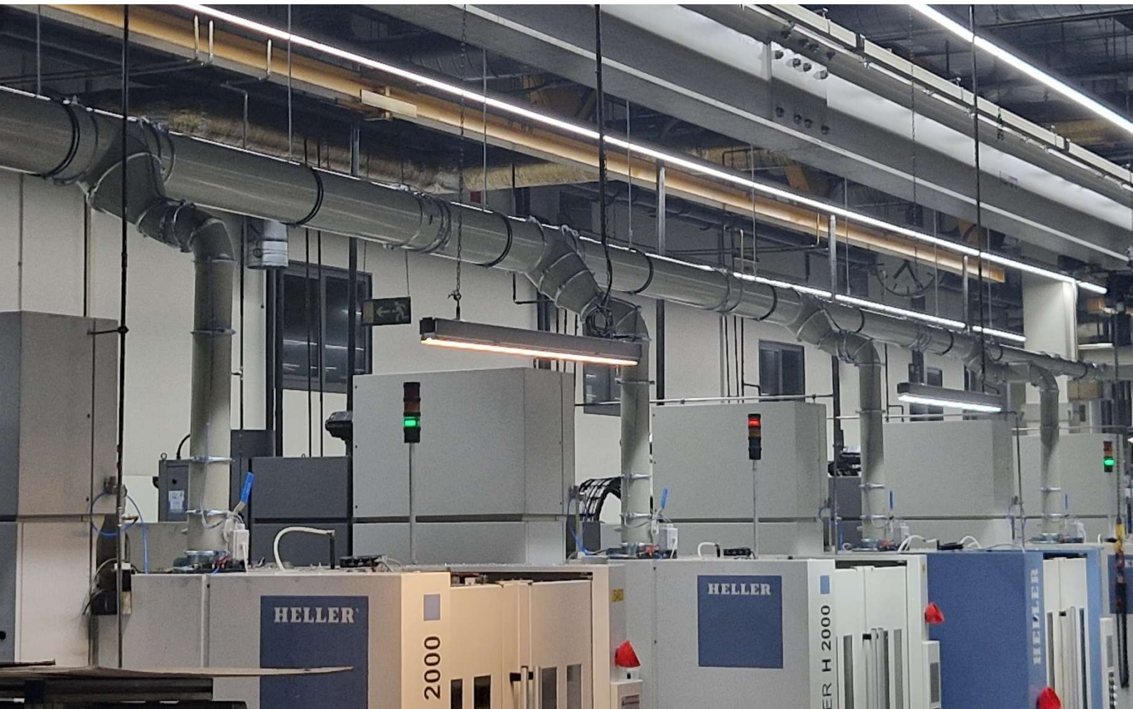
Bild: Zentrale Absauganlage für insgesamt 12 BAZs
