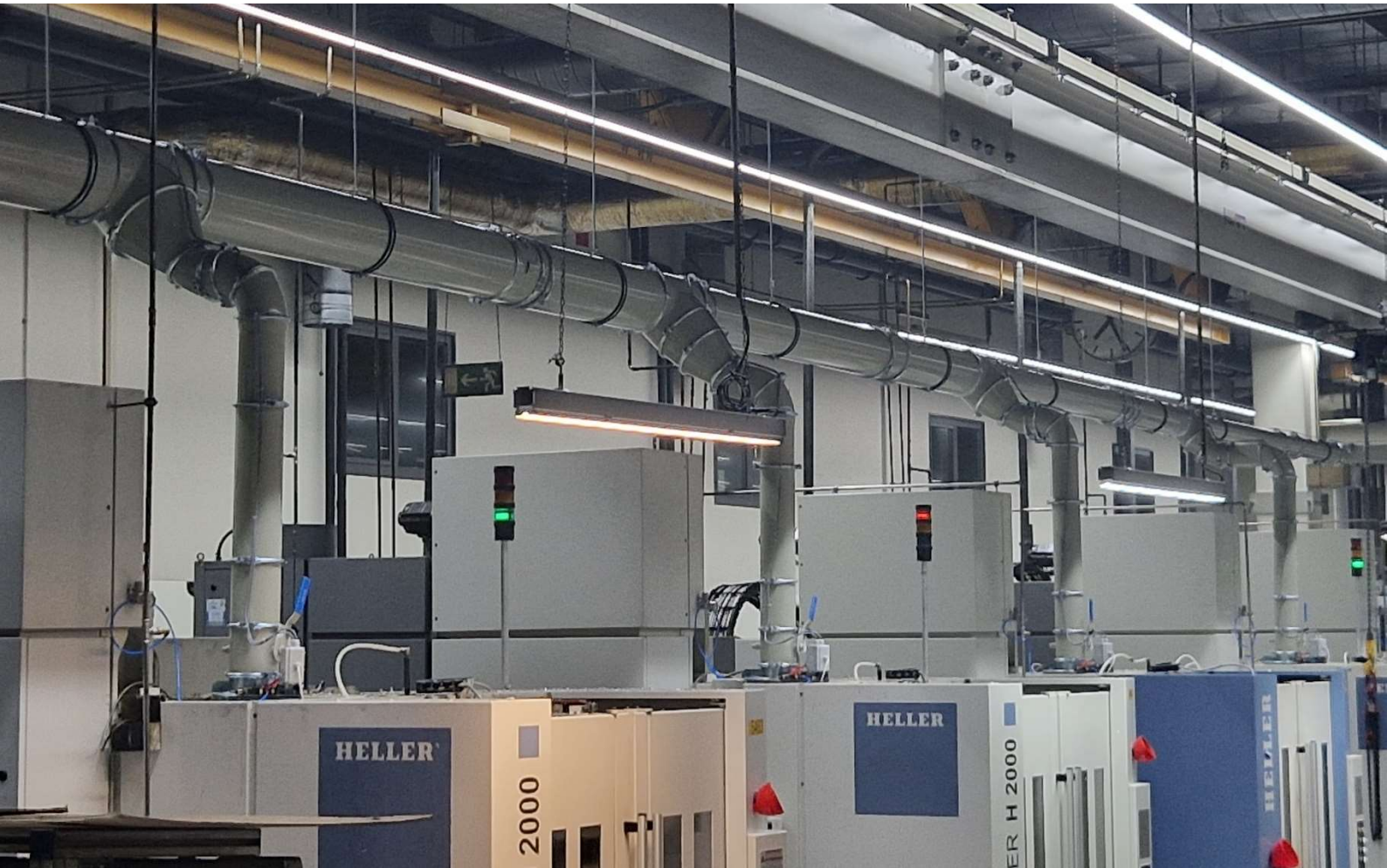
Bild: Zentrale Absauganlage für insgesamt 10 BAZs
